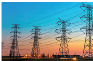
전기 기기 정기 점검
